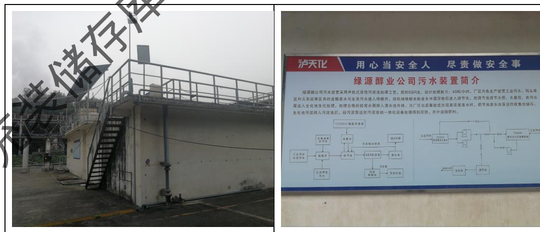
图 9.2-1 泸天化绿源醇业有限责任公司污水处理装置现场图
